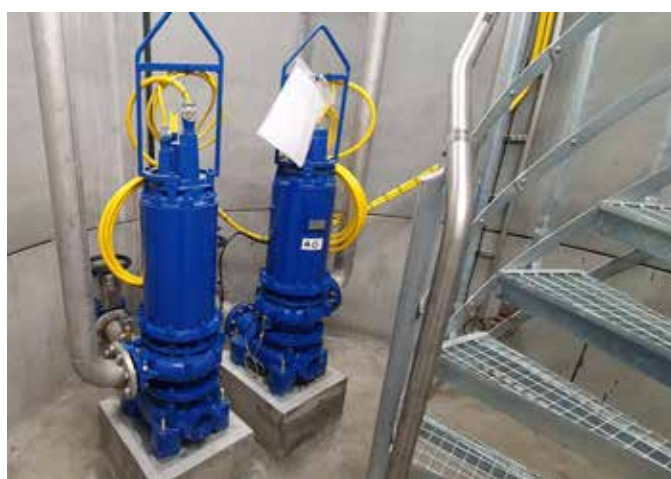
TØRT: Pumpene står tørt og fint, enkelt å arbeide rundt. (Foto: Axflow)
