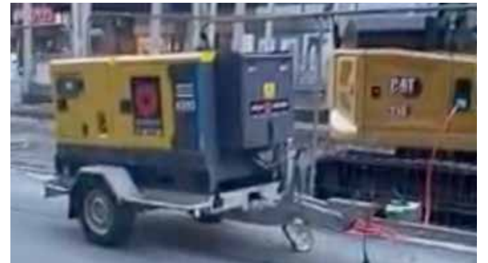
AGGREGAT: El-graveren ble ladet med dieselaggregat i Oslo. Utløste omfattende raljering i sosiale media. (Foto: Screenshot fra video på Facebook)
