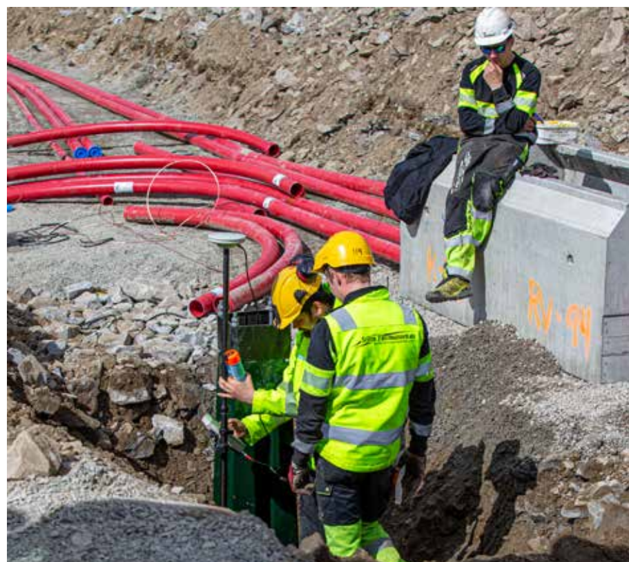
NY FORSKRIFT: Ledningsregistreringsforskriften skal sørge for at infrastruktur under bakken nøyaktig stedfestes og dokumenteres, bl.a. for å hindre kostbare graveuhell. (Foto: Jørn Søderholm).
