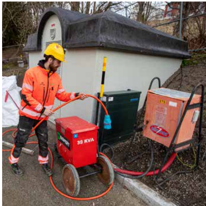
STRØM: 400V er mangelvare i Trondheim. Trafoen like ved anlegget leverer 230V. Innleid omformer sørger for resten. Vegard Lykken får ladet batteriet fullt på fem timer, og rekker et ti prosents påfyll i løpet av lunsjen.
