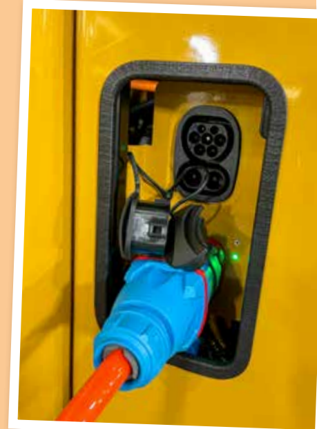
ELEKTRISK: Ny støtteordning skal få fart på ladekapasitet til maskiner og utstyr. Her ladekontakten på en Cat-basert Z-Line 310.
