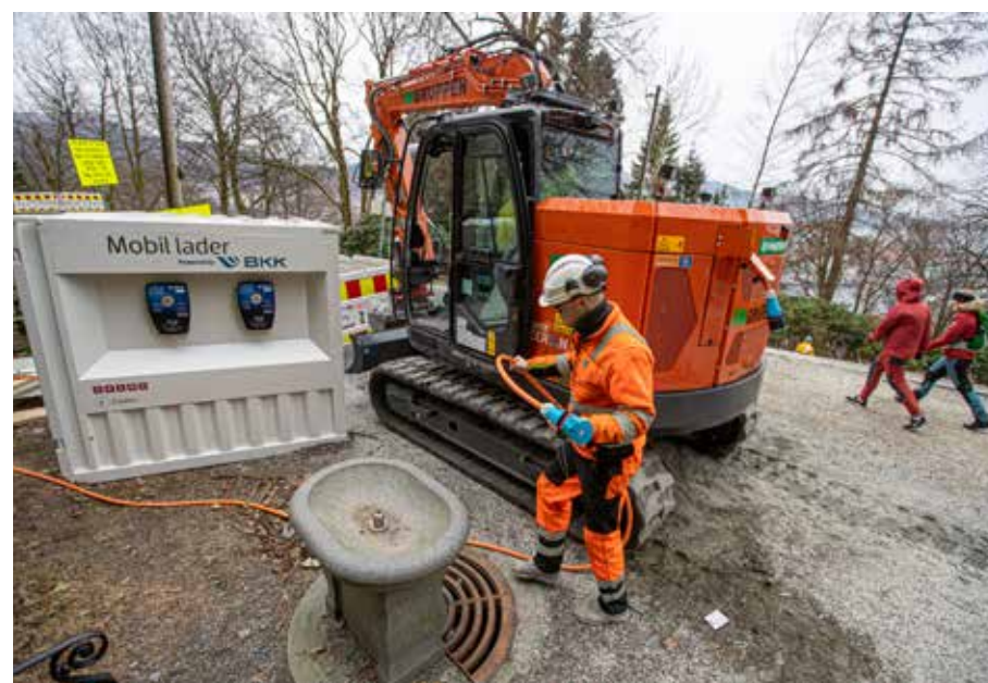
LADING: Kontaineren med ladere og batteribank er koblet til et byggestrømskap. (Alle foto: Jørn Søderholm)
