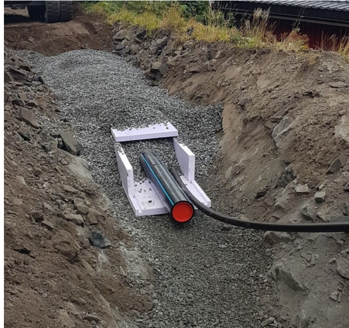
Figur 1.9: Røyrrøft med isolasjonsplater rundt røyret. Bilete frå Ringvegen, Vestby kommune. Foto: Inga Rise 2020
