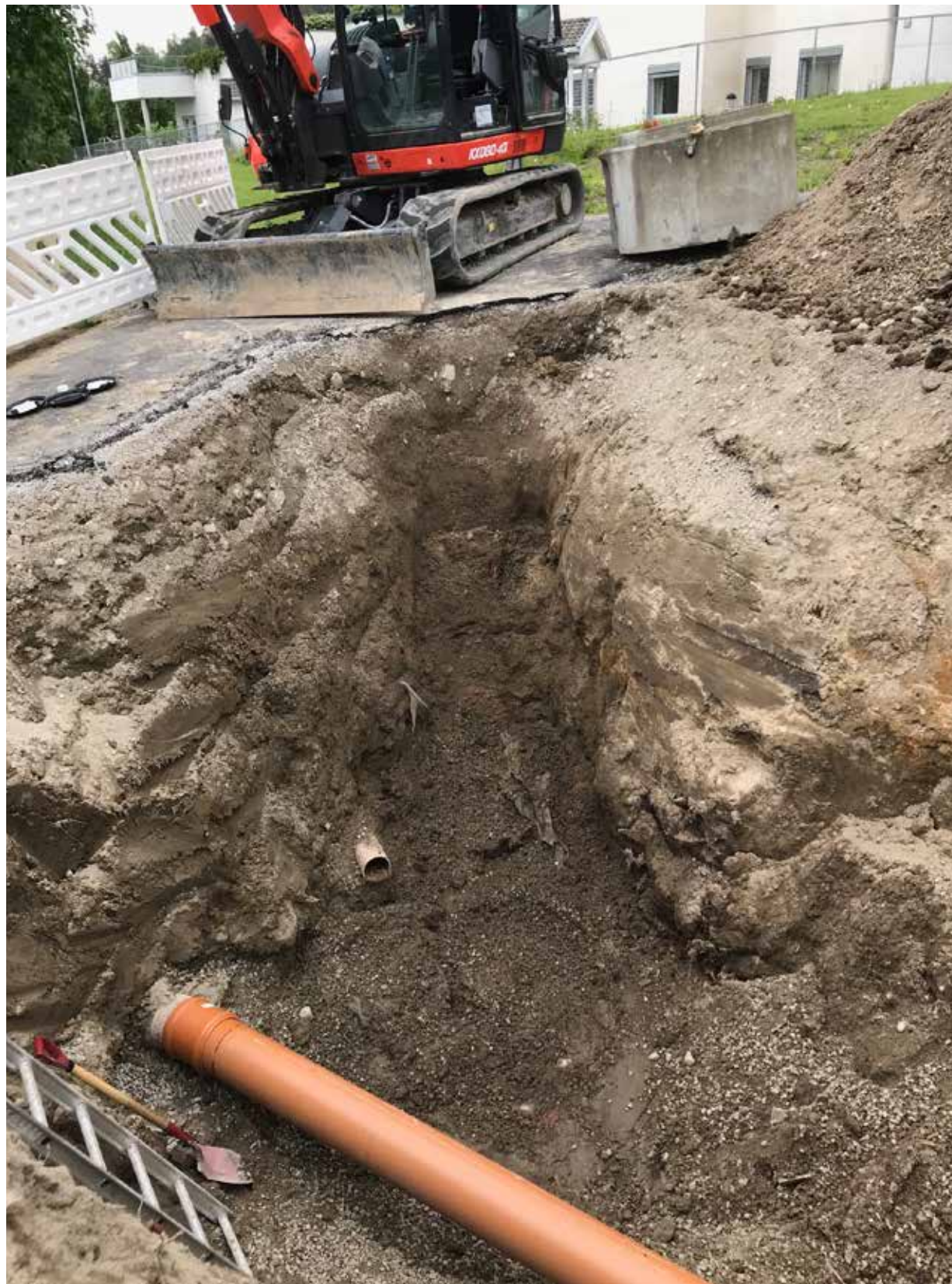
BRATT: Bratte, usikrede skråninger og manglende rømningsvei er en sikker måte å skaffe seg stoppordre på. (Foto: Arbeidstilsynet)
