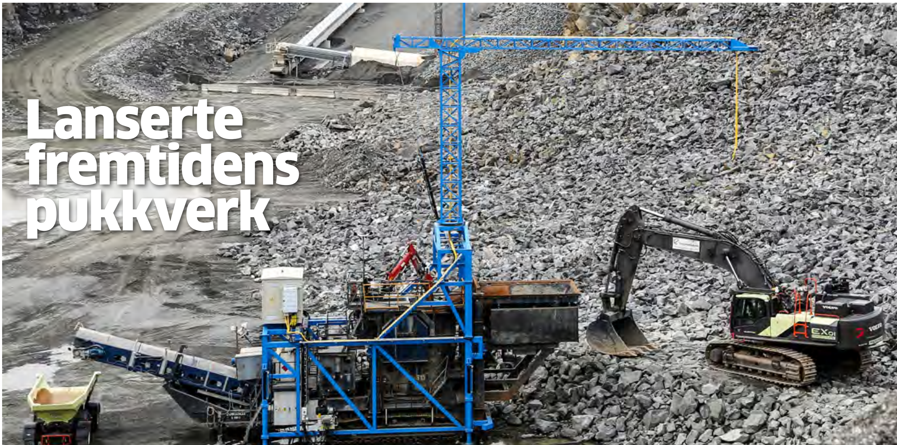
ELEKTRISK: Testing av verdens første "utslippsfrie" pukkverk er i gang utenfor Göteborg.
