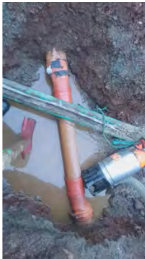
GRAVESKADE: Det er ikke sikkert kablen ligger der den ble påvist. Hva gjør du da? (FOTO: STATENS VEGVESEN)
