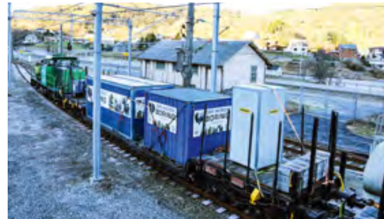
TOGET: Det tyskproduserte lokomotivet trekker vogner som bl.a. inneholder kompressorer, vanntank, kran, borerigg, mannskapsbrakke og et eget toalett. Den største containeren på bildet fungerer som mannskapsbrakke.
