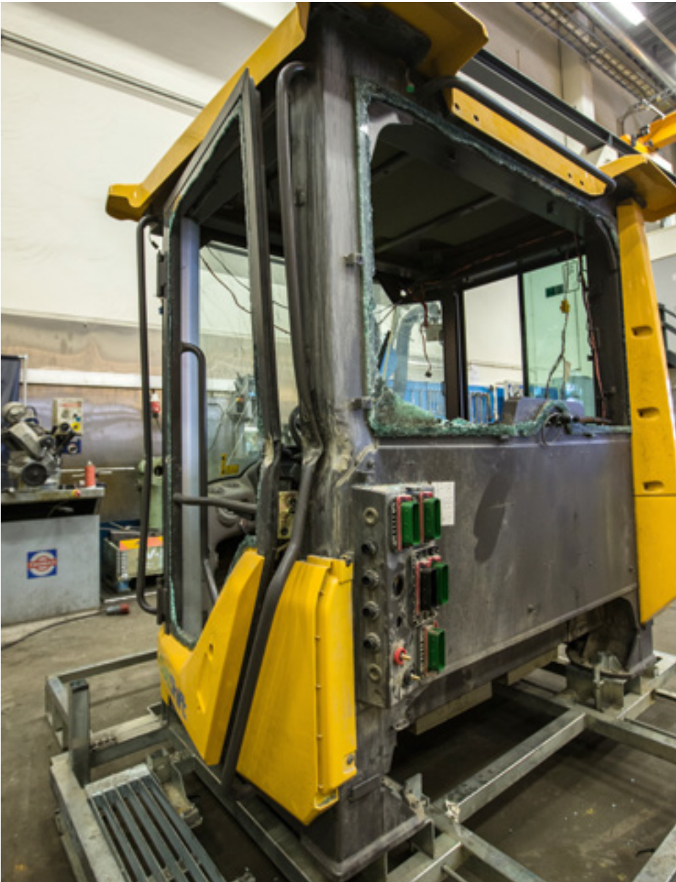
SKADET: Skal en skadet ROPS-hytte repareres eller byttes? Det er maskineierens ansvar. (Begge foto: Jørn Søderholm)
