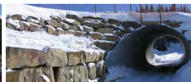
MP 200 flerplaterør som skiundergang - Hafjell
