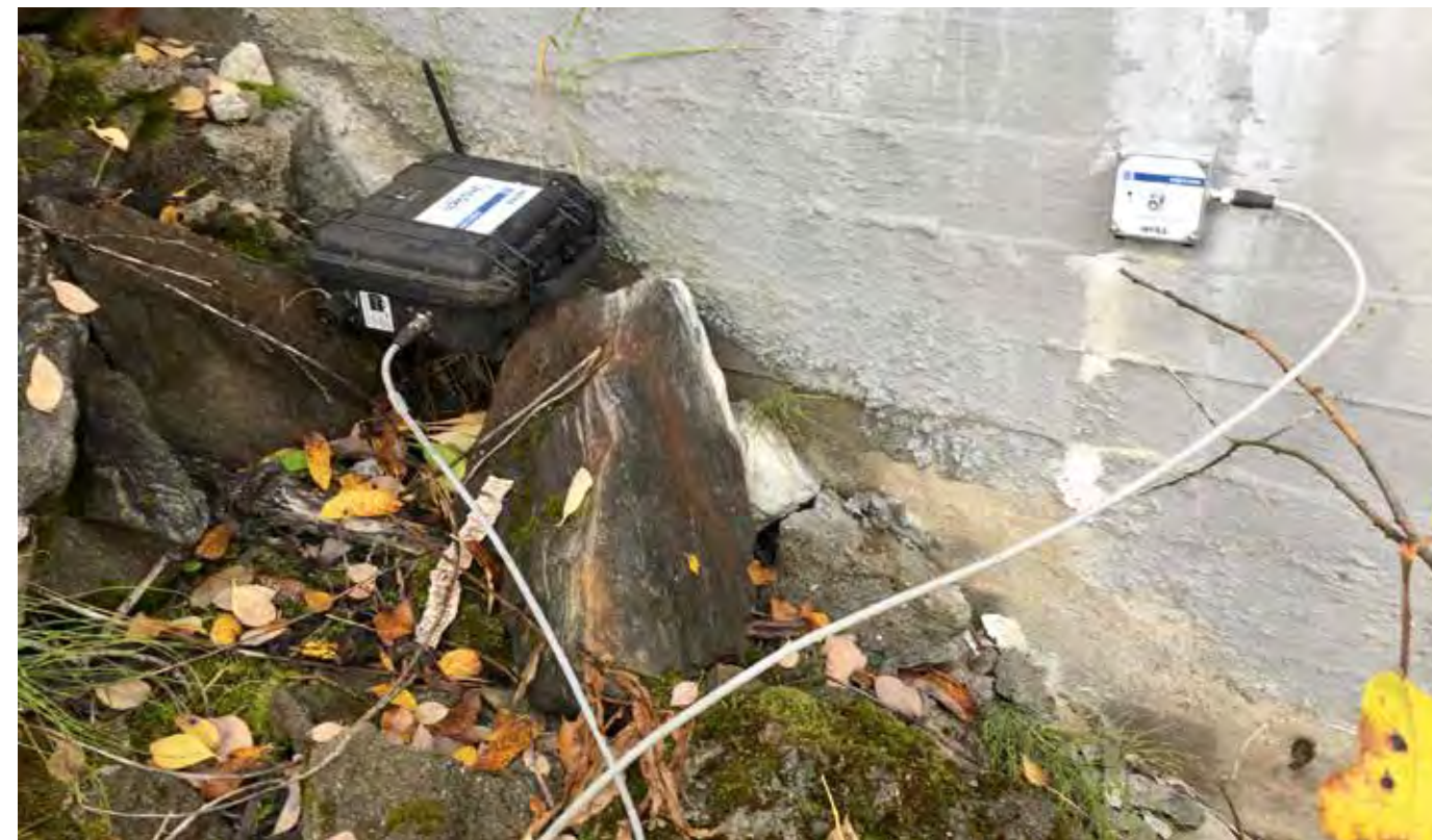
MONTERT: Måleapparat på husvegg. (Foto: Protech Consult)
