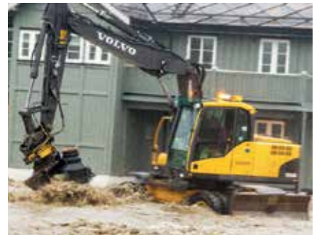
SKADER: Klimaendringene antas å gi endrede nedbørmønstre som vil presse på vann- og avløpsystemer som ikke er dimensjonert til å takle større mengder overvann enn i dag. Bildet er fra flommen i Kvam, våren 2013. (FOTO: JØRN SØDERHOLM)
