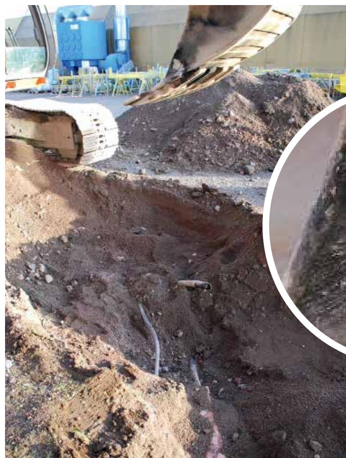
SVIDD: Sjøkk merket på skuffa etter at den traff en kable med spenning på. Det er dårlig sort å stå i nærheten da. (FOTO: TRAINOR AS)
