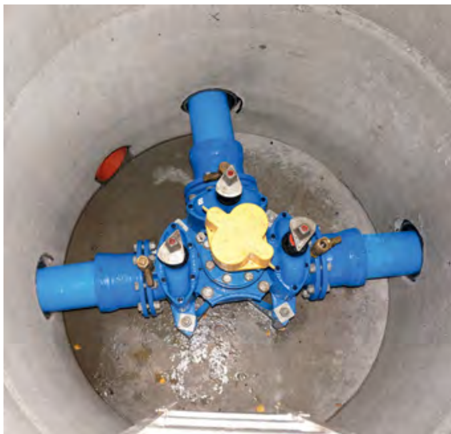
RIKTIG: Et eksempel på en trygg og oversiktlig prefabrikkert vannkum, slik Rørinspeksjon Norge ønsker den. Produsert og installert med DN150 armatur i henhold til kravspesifikasjonen 2014.
