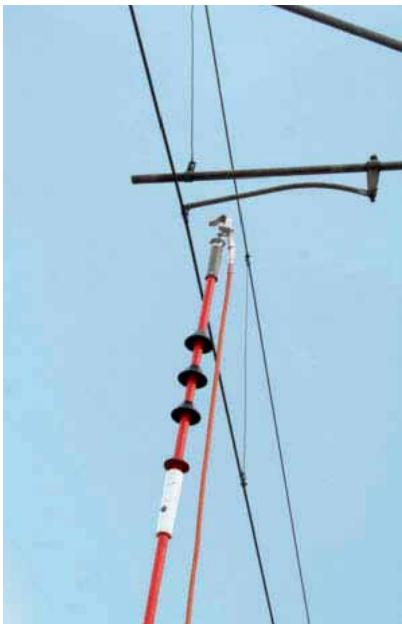
Utkoplet Kjøreledningen må jordes manuelt av to mann for at elkraftsentralen kan slå av kjørestrømmen.
