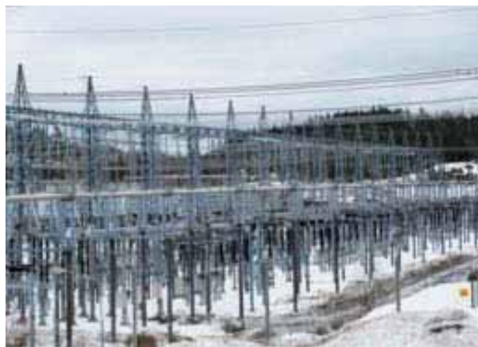
Kraftig Her, ved Kristiansand transformatorstasjon, skal den nye forbindelsen kobles til det norske strømmettet.
